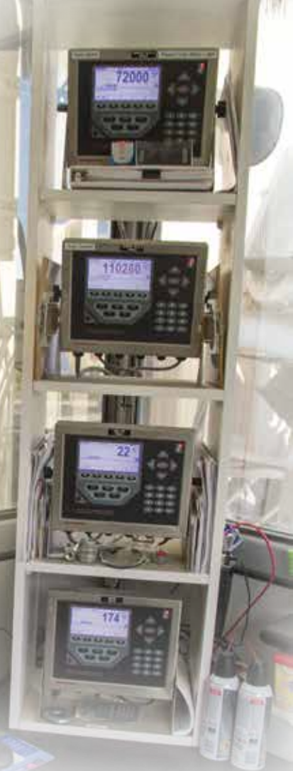
Cuatro indicadores digitales de peso 820i se comunican con un programa PLC personalizado para llenar automáticamente y con precisión las bolsas de QUIKRATE a un peso determinado.
