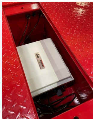
Figura 5-4. Cavidad de la caja de empalmes
